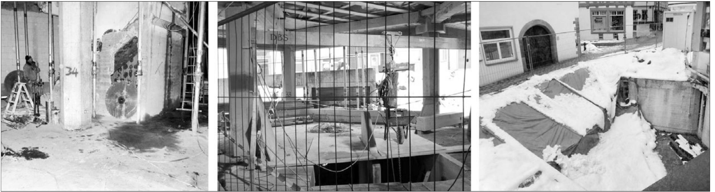
Im Marktdreieck geht es rund: Nicht nur, dass sich riesige Sägeblätter ihren Weg durch Beton bahnen (Bild links), um die erforderlichen Ausschnitte in die vorhandene Bausubstanz zu schneiden, wie der mit Folie abgedeckte Bereich des mittleren Bildes zeigt, auch die Außenarbeiten gehen voran: Das Marktdreieck wird um eine Art „Lichtlof“ reicher; damit dieser entstehen kann, bedarf es eines stützenden „Verbaus“ gegenüber der Zwerchgasse (Bild rechts). Fotos: Greiner
