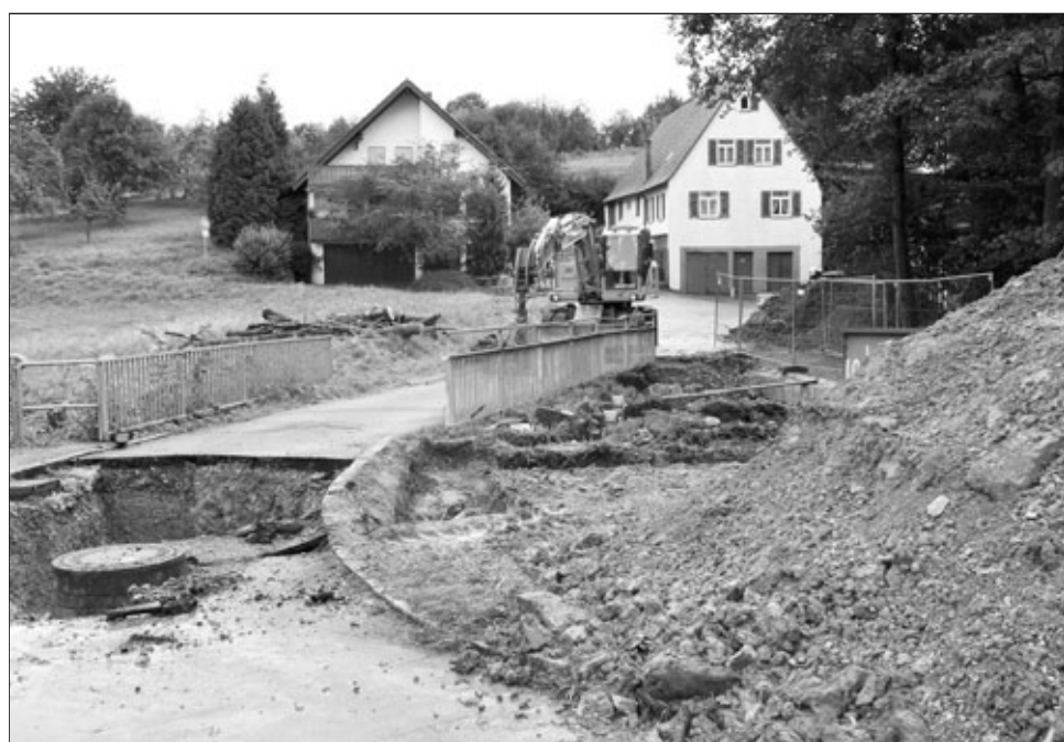
Die Zipfelbachbrücke in Bittenfeld wird abgebrochen und gegen eine „leistungsstärkere“ ersetzt. Die Arbeiten dauern etwa vier Monate. Foto: Peters
