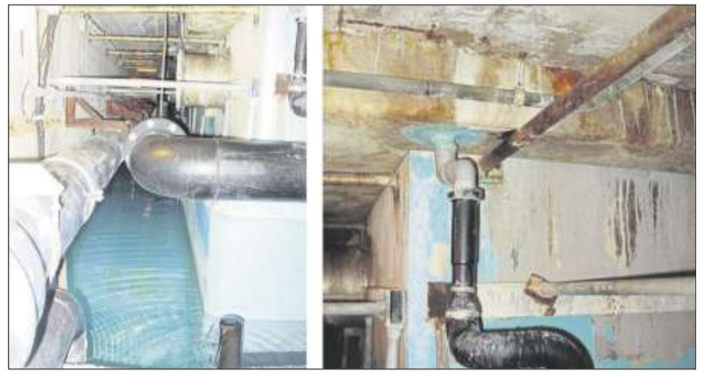
In den unteren Geschossen jedoch, dort, wo die Bädertechnik liegt, bedarf es der Sanierung.
