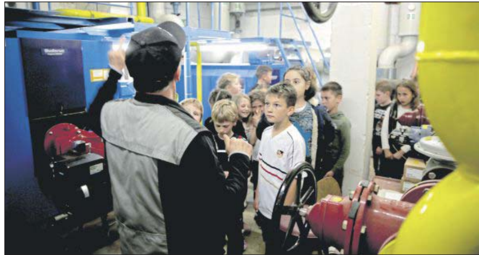
Klimaschutz fängt bei den Jüngsten an: Die Energieagentur bietet Schulprojekte an, in denen Kinder für Umwelt und Klima sensibilisiert werden, wie zum Beispiel eine Klasse im Heizungskeller der Welzheimer Bürgfeld-Gemeinschaftsschule. Archivfoto: Büttner
