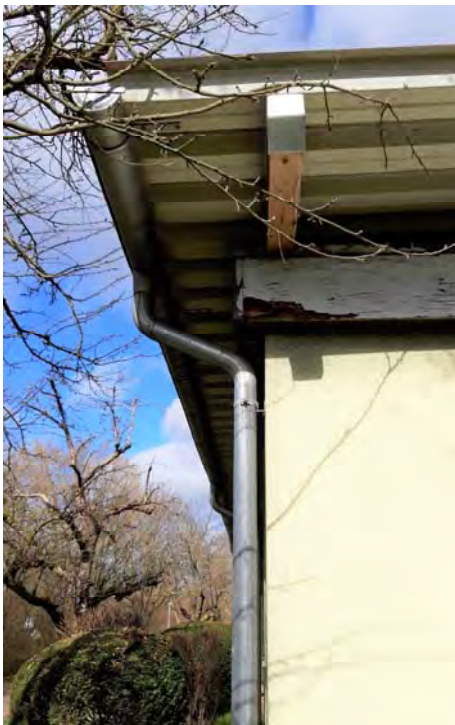
Abb. 16: Spalten und Hohlräume im Dachbereich des Gebäudes der ehemaligen Straßenbauverwaltung
