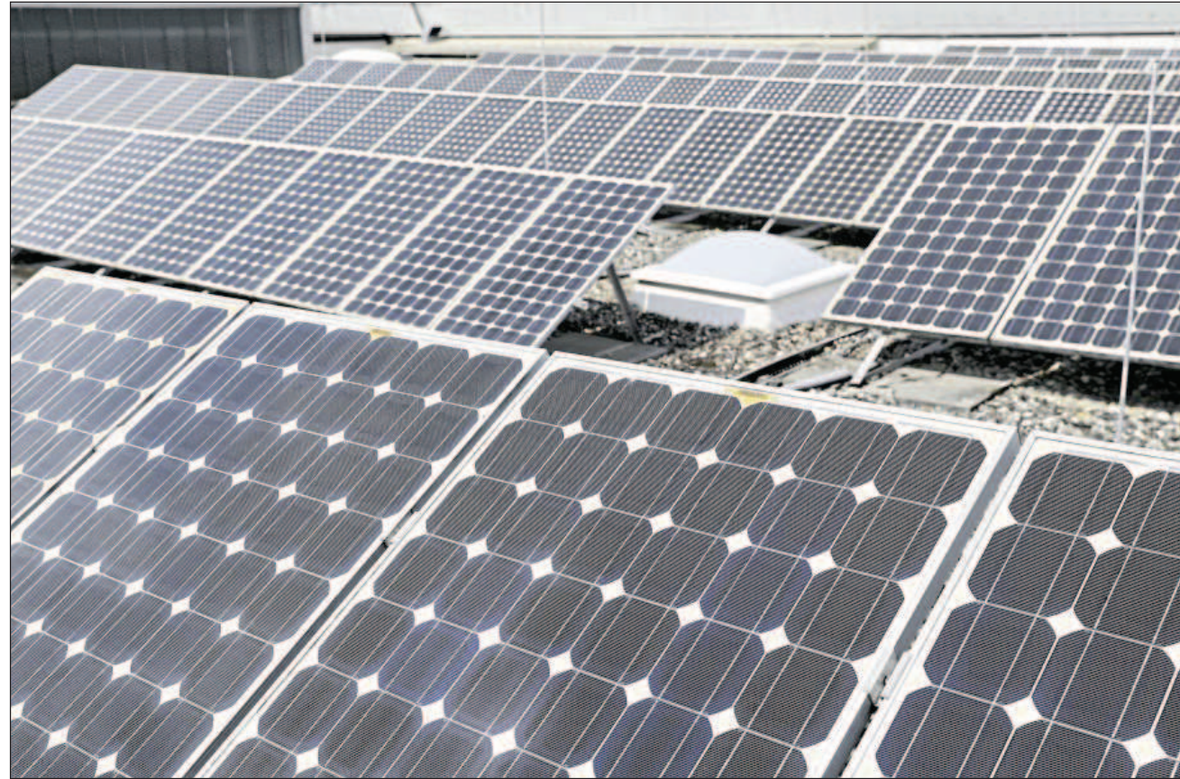
Fotovoltaik-Anlage auf dem Dach des Druckhauses Waiblingen.
