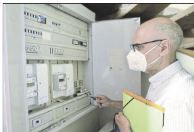
Check des Zählerkastens.
